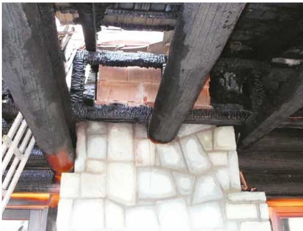
Následek nesprávného provedení prostupu
