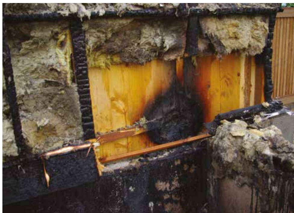
Detail místa vzniku požáru
