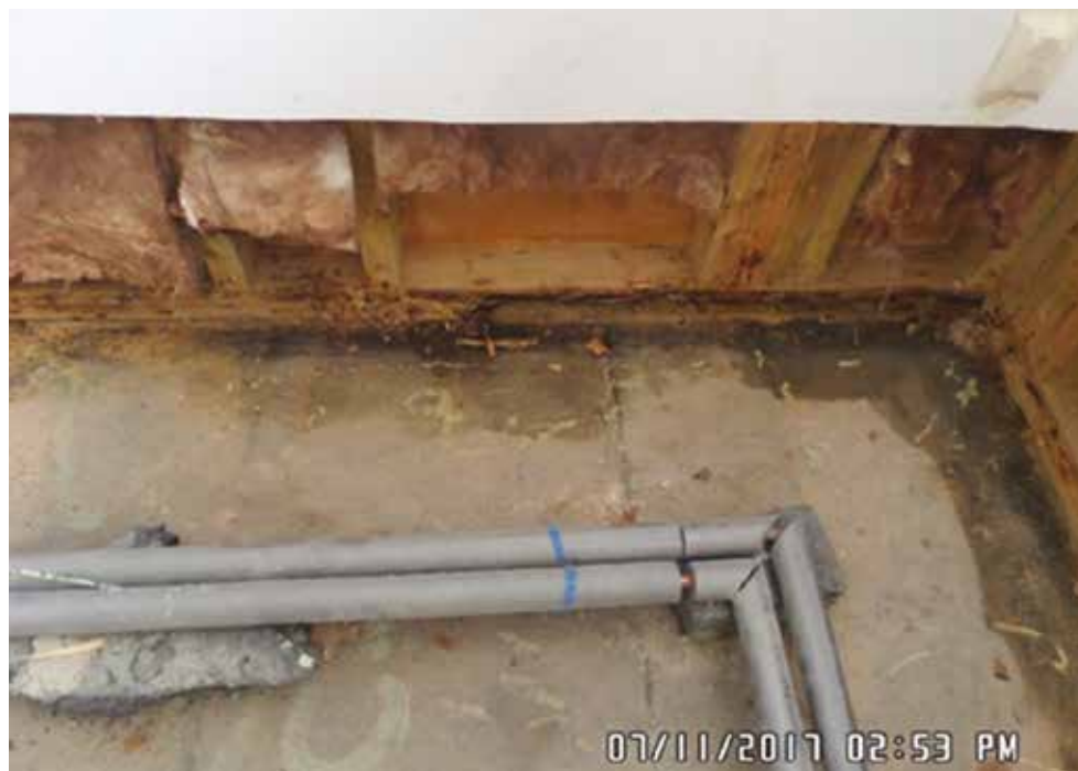
Podmáčení dřevostavby vzniklé prasklinou v potrubí odpadové vody. Musela být provedena kompletní rekonstrukce a výměna dřevěných dílů a zároveň byl nainstalován systém Moisture Guard
