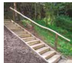
Vruty WT v konstrukci venkovního schodiště na Českolipsku poblíž skalního hradu Děvín
