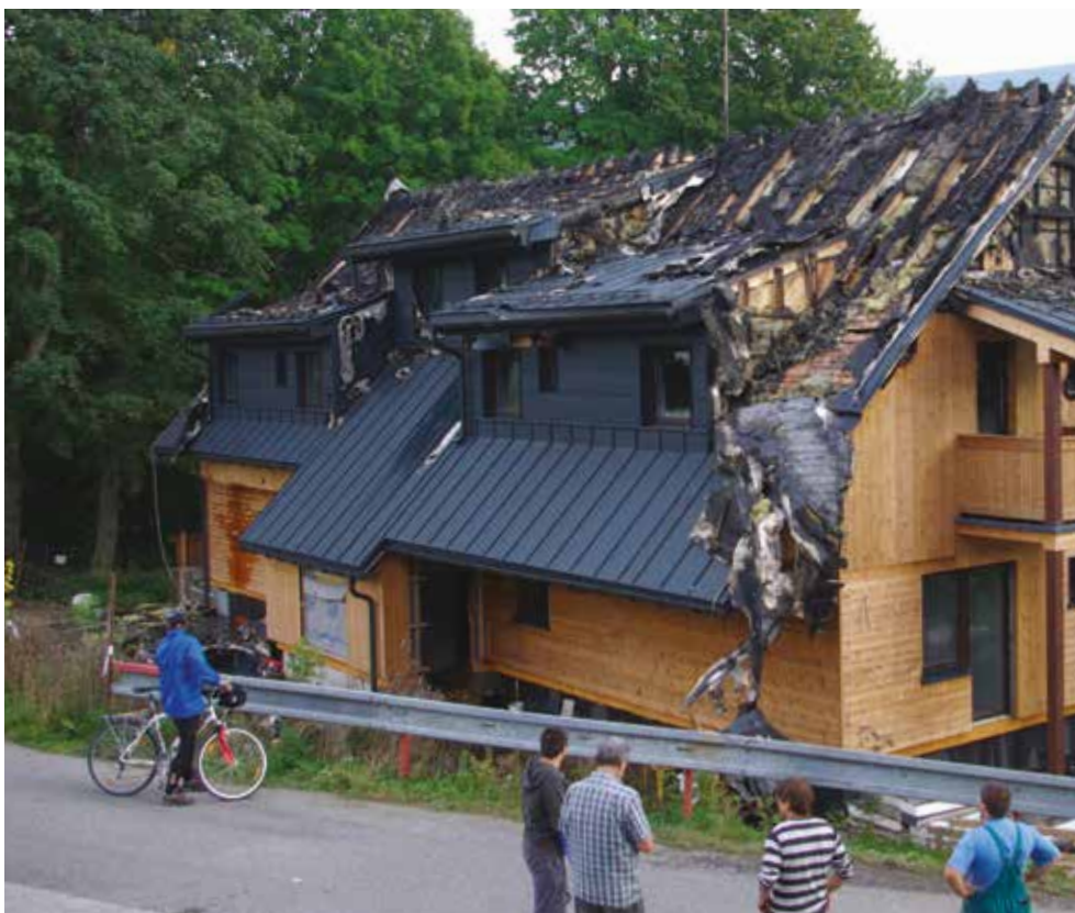
Dům těsně po požáru
