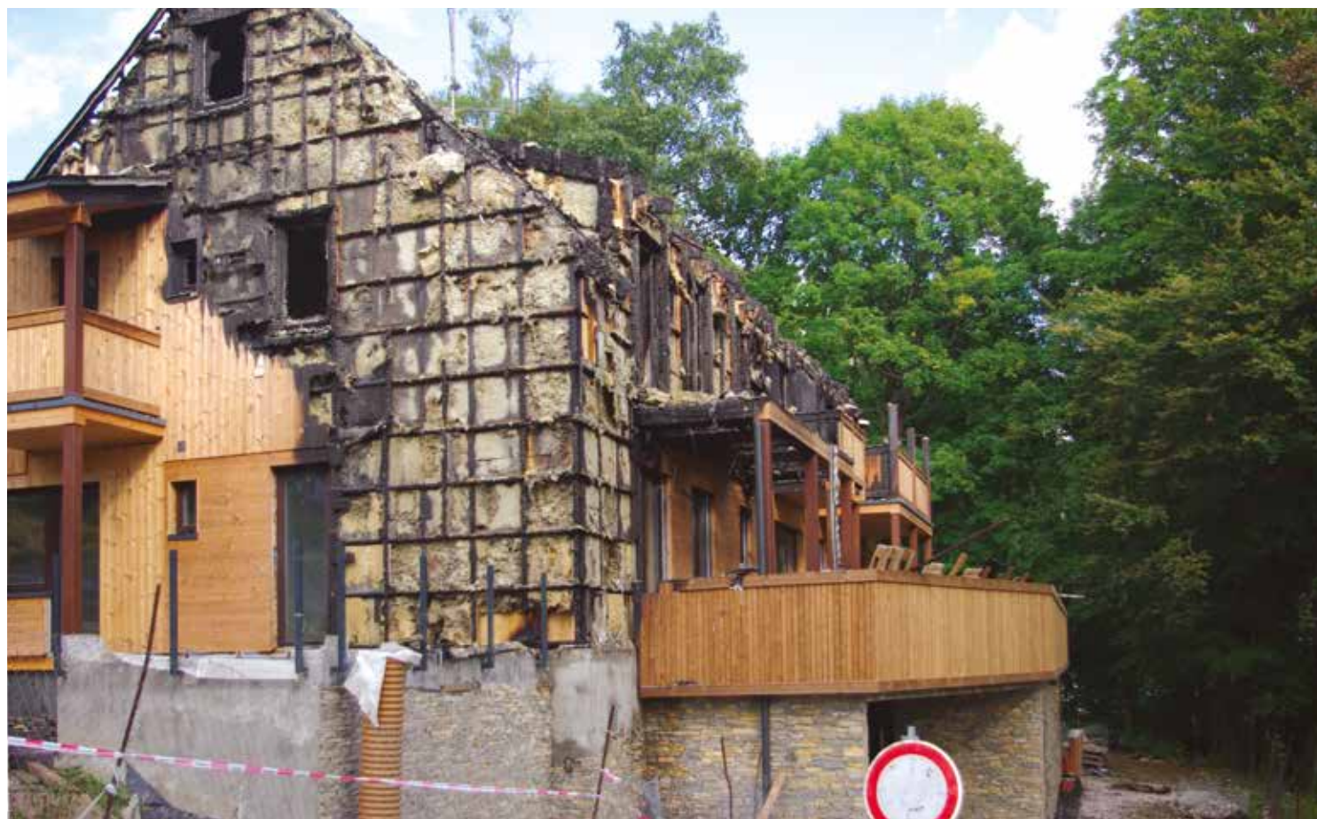
V rámci zachraňovacích prací bylo potřeba odstranit všechny konstrukce, které ohrožovaly okolí, především přesahy balkonů
