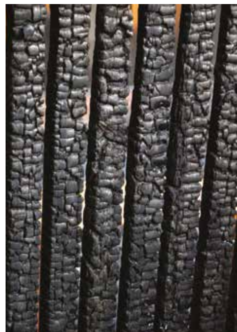
Dřevo požárem uhelnatí a poté přestává hořet – díky tomu zůstala i nejhůře postižená místa stavby stát
