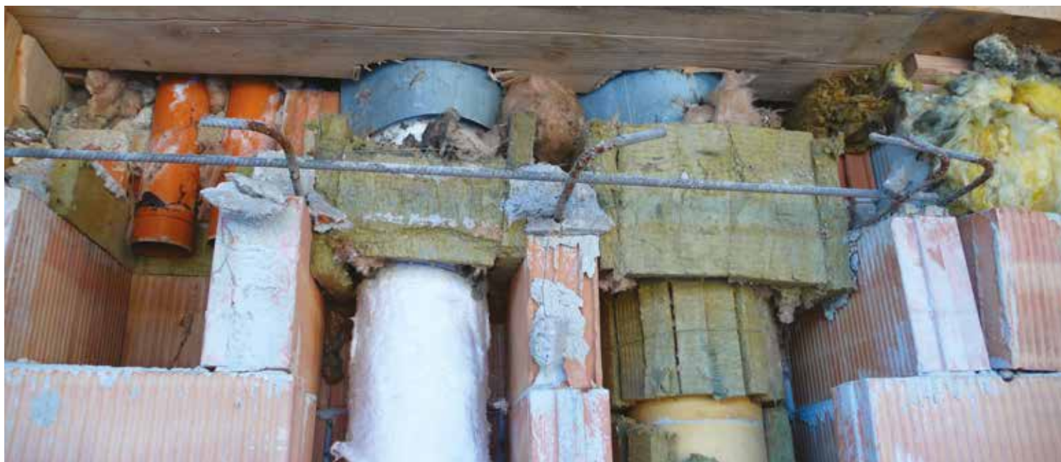
Detail nesprávného provedení prostupu komínu ve srubu
