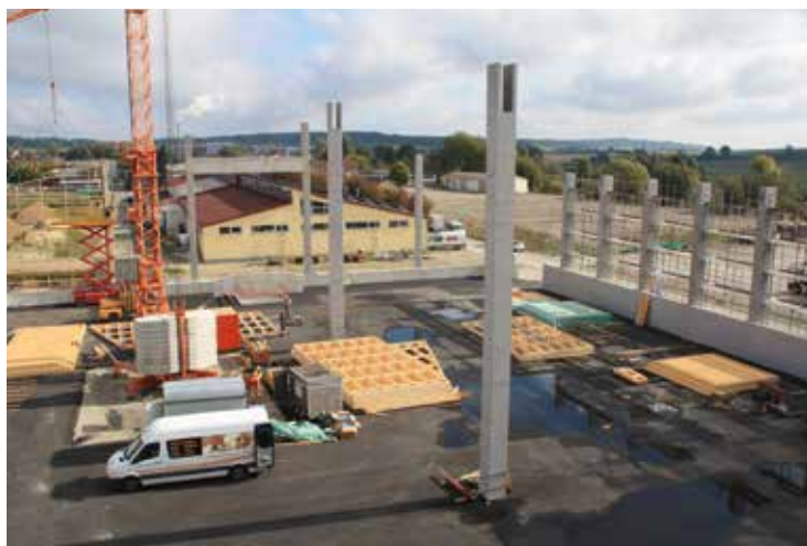
Pro zkrácení doby výstavby bylo mnoho prvků současně vyráběno v závodě a na místě stavby
