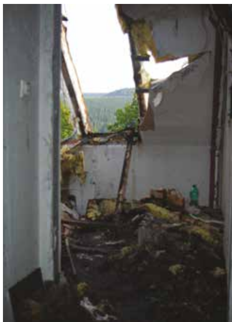
Nejhůře zasažené místo krovu, jediné, kde se propadla střecha
