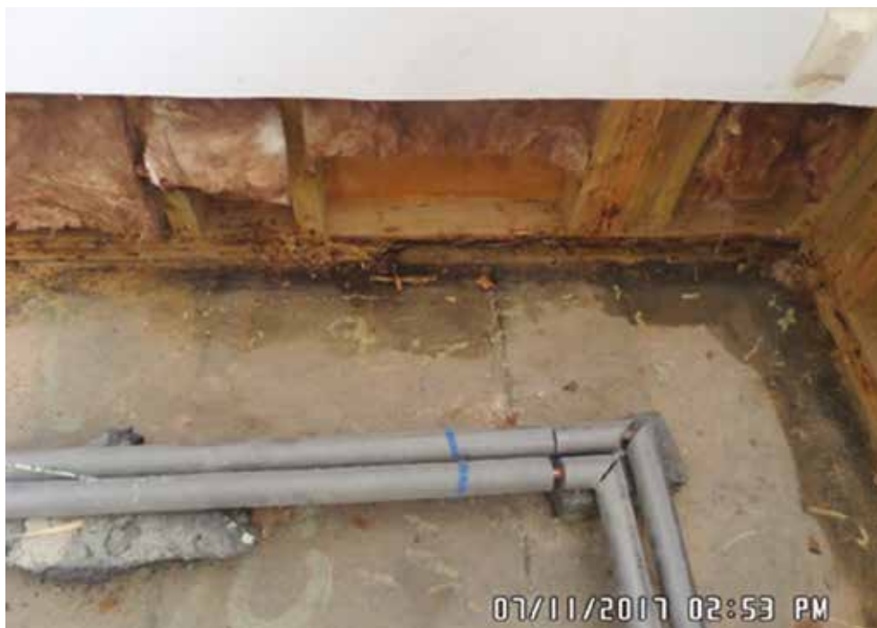
Podmáčení dřevostavby vzniklé prasklinou v potrubí odpadové vody. Musela být provedena kompletní rekonstrukce a výměna dřevěných dílů a zároveň byl nainstalován systém Moisture Guard
