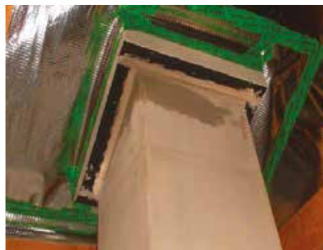
Příklad instalace prostupu komínu hořlavou konstrukcí šikmé střechy s tepelnou izolací z pěnoskla
