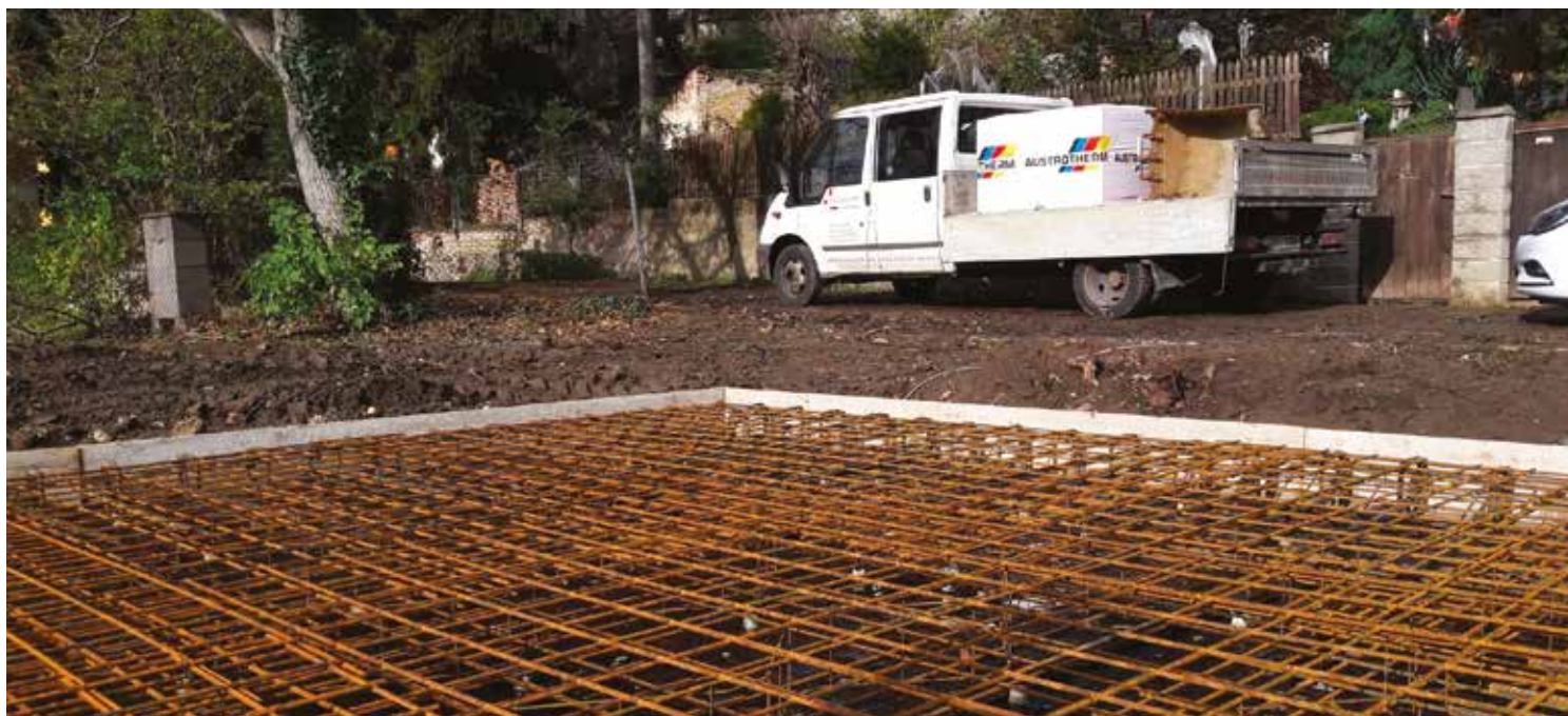
Založení domu na silné železobetonové základové desce je obecně dražší, proto se zpravidla používá při složitých základových podmínkách
