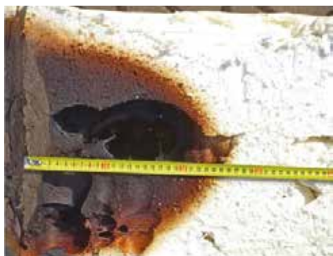
Příklad z praxe – vstup komína stříkanou izolací – zuhelnatělá izolace až do vzdálenosti 270 mm od kovového pláště komína
