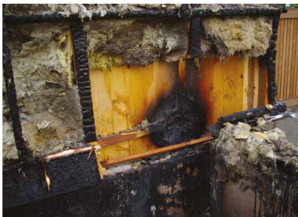
Detail místa vzniku požáru
