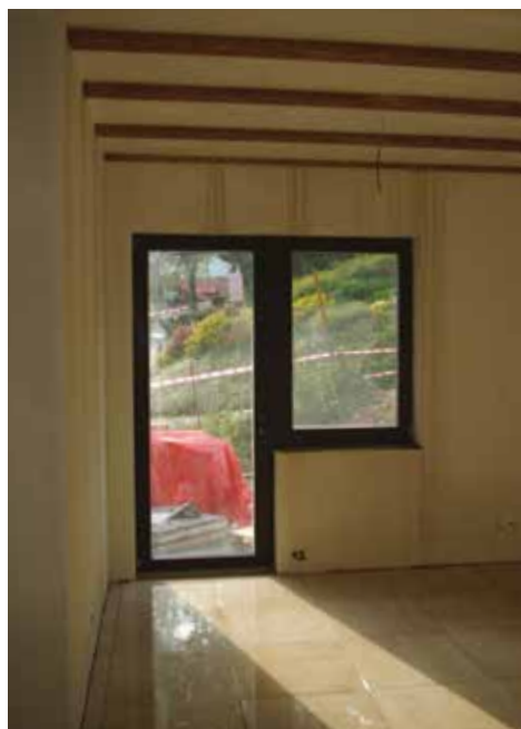
Důsledky požáru v 1. NP – destrukce vodou
