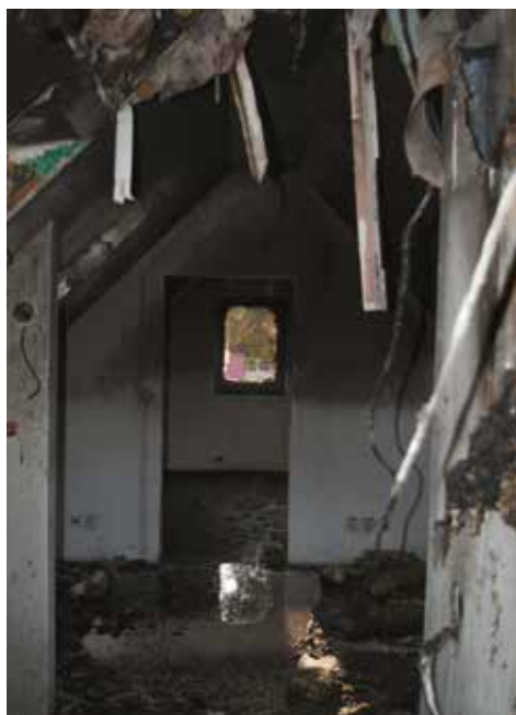
Podkroví – pohled do nejvíce zasažené části s úplnou devastací prostor ohněm, vodou a kouřem
