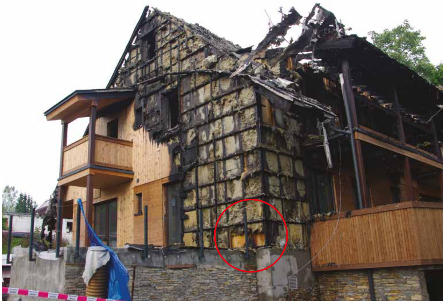
Místo vzniku požáru je dole ve střední části fotografie
